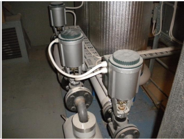
Figur 4. Styrventiler med motor i undercentral.
