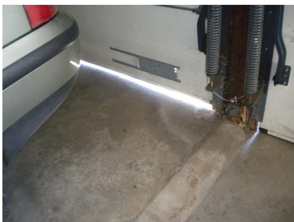
Figur 6. Garageport med dålig tätning mot mark.
